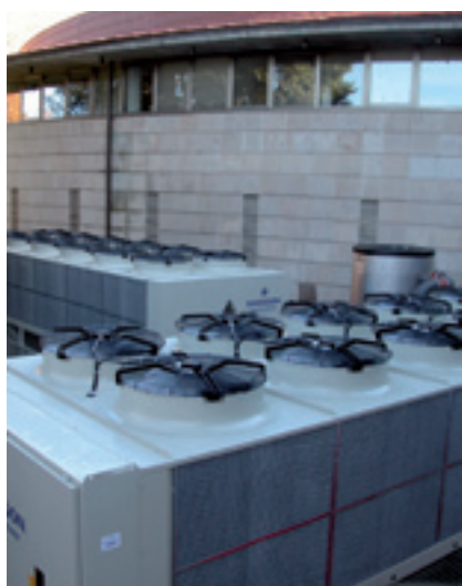
Vista parcial das novas plantas arrefriadoras
