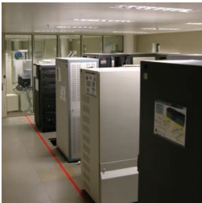
VISTA PARCIAL DO CPD NO CESGA
