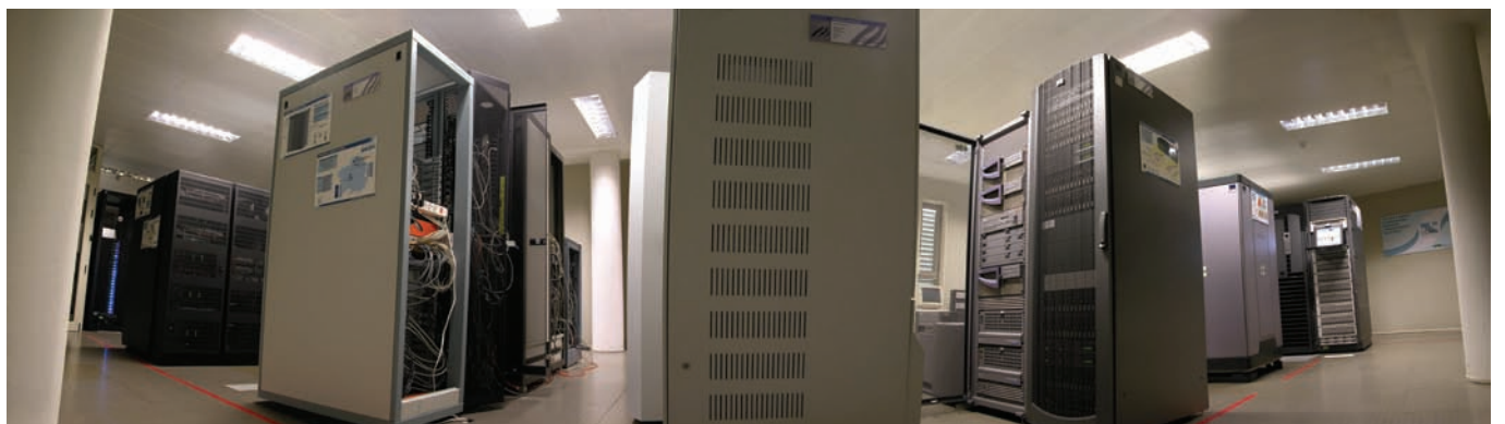
PANORÁMICA COS SERVIDORES INSTALADOS NO CPD DO CESGA
